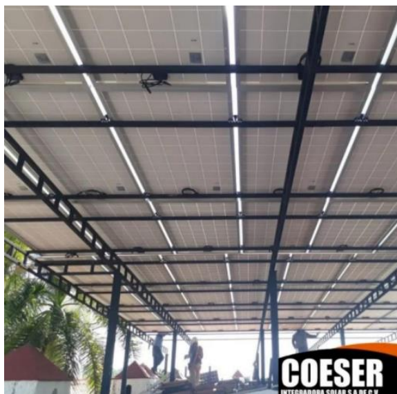
Ilustración 6 "Sistema Interconectado a la red de Comisión Federal de Electricidad"
