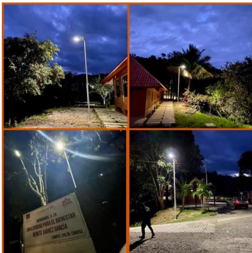
Ilustración 5 “Luminaria Instalada Por COESER”
