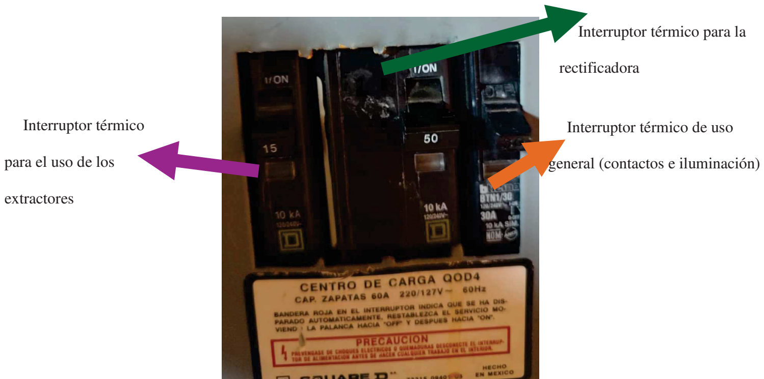
Ilustración 16 Centro de carga del laboratorio
