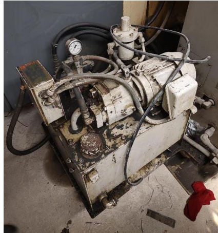
Figura 84. Bomba hidráulica antigua.
