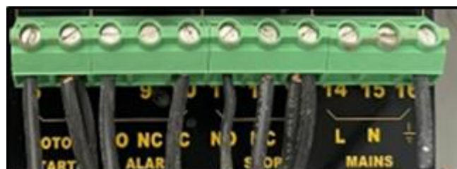
Figura 7.5 Conexiones de energía y relé, (Autor).
