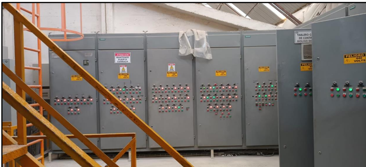
Figura de anexo 3.1 Señalización en tableros.
