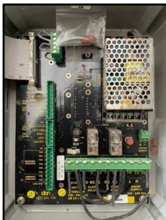
Figura 7.3 Vista interna de la unidad WDC4,
