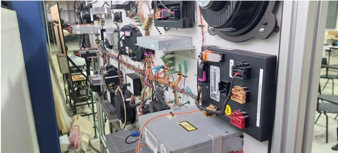
Figura 3.4.1.- Módulo sucio y abandonado
