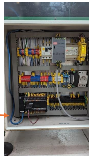
Ilustración 71 Conexión del Gabinete Motor HVAC B
