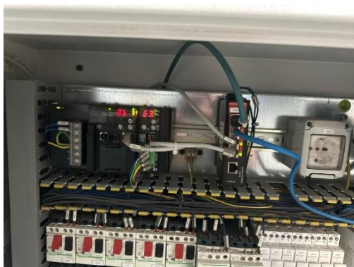
Ilustración 67 Conexión del Gabinete HVAC B
