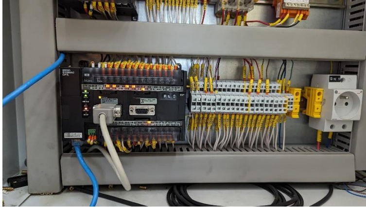
Ilustración 44 conexión de RJ45 a nuestro PLC
