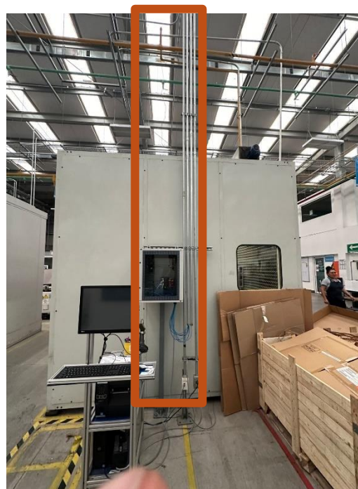
Ilustración 74 Bajada al Gabinete o switch principal
