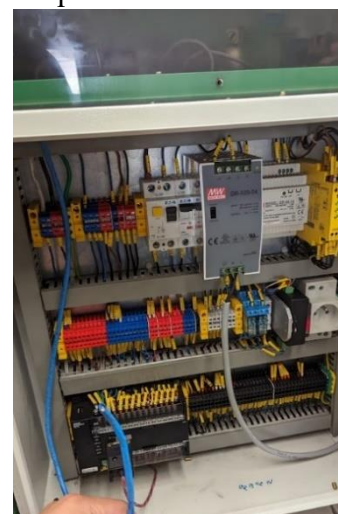
Ilustración 39 Cableado Ethernet hacia los gabinetes
