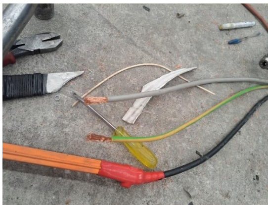
Figura 19: Conexión eléctrica a los rieles conductores
