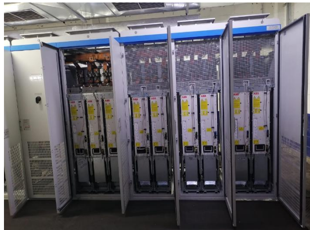
Imagen 14.20 Interior De Tableros De Mando De Motores.
