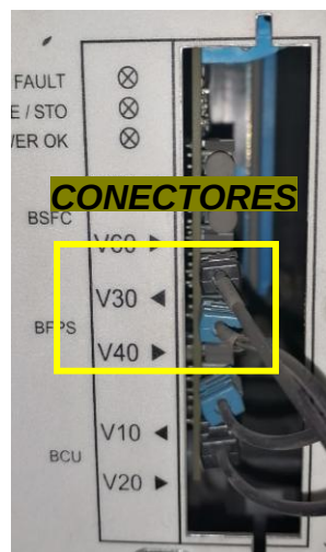
Imagen 14.91 Conectores De Fibra Óptica “V30 Y V40” De Ventilador Inferior.
