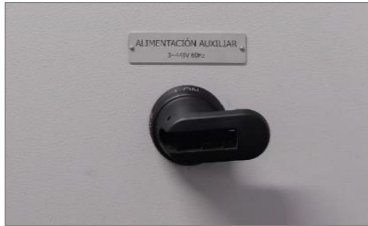
Imagen 14.106 Interruptor Rotativo De Alimentación Auxiliar.
