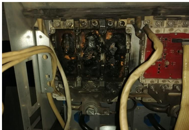
Imagen 9.1 Ejemplo De Explosión Dentro De Los Módulos Inversores De Corriente.
