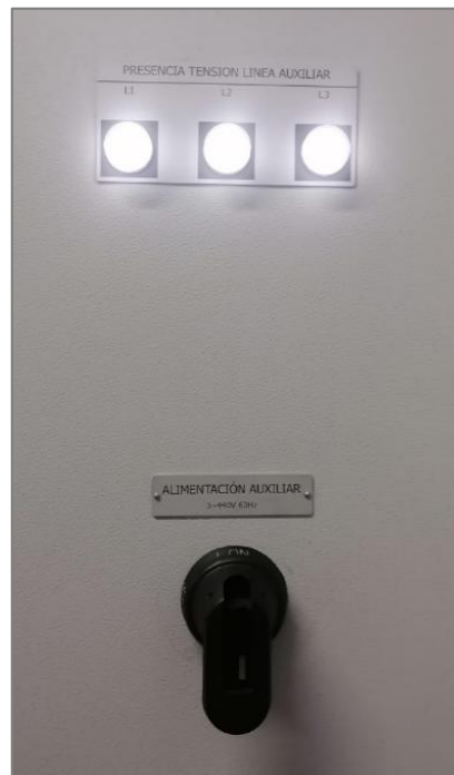
Imagen 14.107 Indicación De Presencia De Tensión En Cada Línea Auxiliar.
