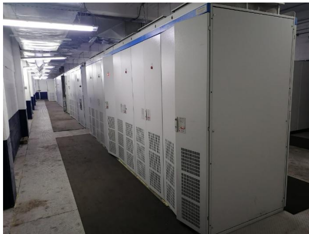
Imagen 14.19 Tableros De Mando De Motores.
