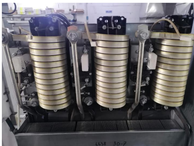
Imagen 14.65 Vista Lateral De Modulo Inversor Sin Tapa Superior.
