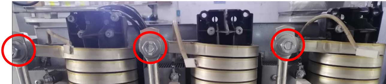
Imagen 14.86 Tornillería De Sujeción De Inductores.
