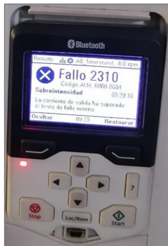
Imagen 14.56 Mensaje De Fallo En Panel De Control.
