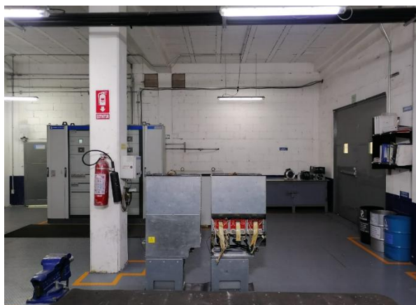
Imagen 13.40 Vista Lateral De Área De Mantenimiento De Módulos Inversores.
