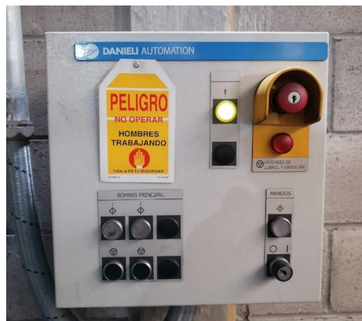
Imagen 14.131 Etiquetado LOTO En Tablero De Control.
