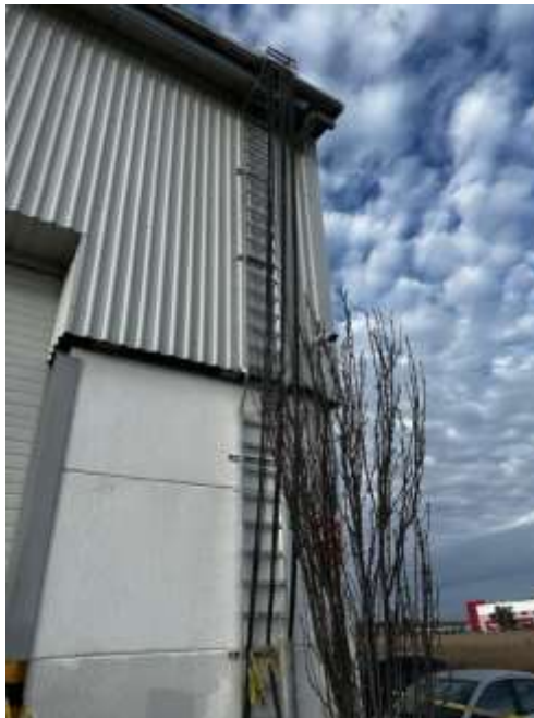
Ilustración 15. Bajada de cableado hacia la subestación
