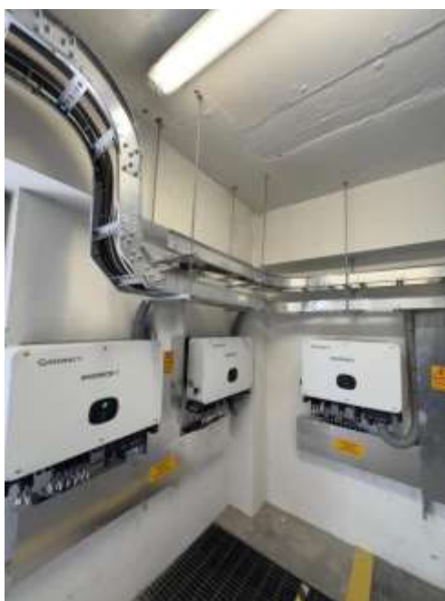
Ilustración 21 Conexion hacia inversores.
