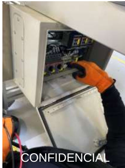
Imagen 30. Tablero de control eléctrico
