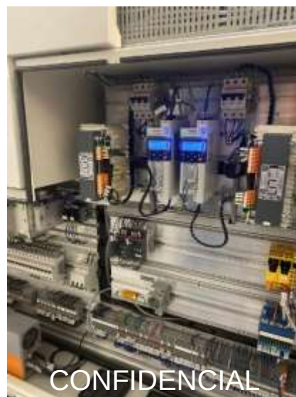
Imagen 31. Tablero de maquina (señales de PLC)
