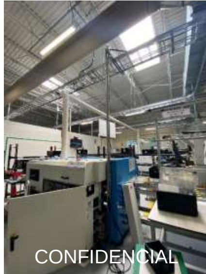
Imagen 32. Bajada para alimentación de motor trifásico
