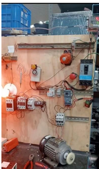
Figura 3.23 Simulación física en tablero de pruebas.
