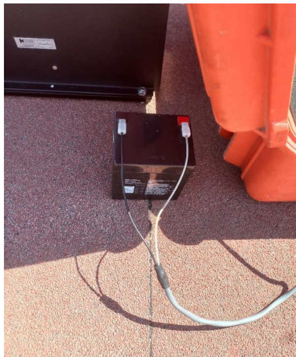
Imagen 68. Conexión a batería
