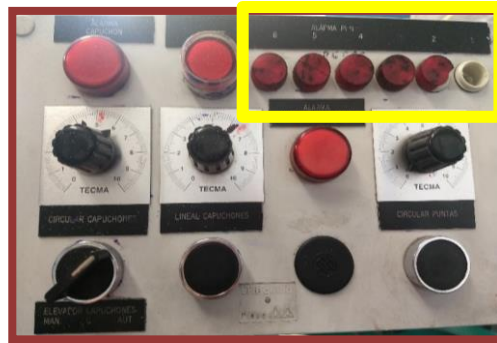
Imagen 1.51 Luces Piloto en mal estado. (Fuente: IEA 2019)
