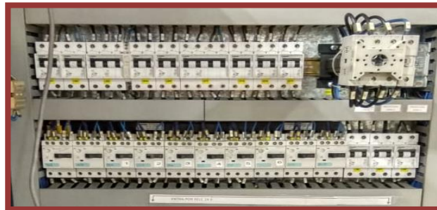
Imagen 1.74 Interruptor Termomagnético de la fuente de alimentación del PLC. [Fuente: IEA 2019]
