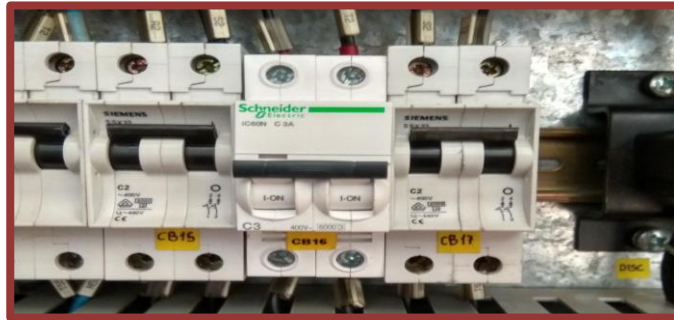
Imagen 1.101 Interruptor Termomagnético nuevo. [Fuente: IEA 2019]
