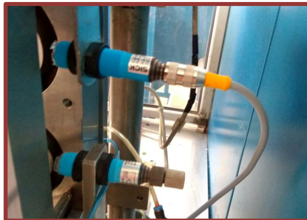
Imagen 1.100 Sensor de Presencia instalado en la estructura del proceso de llenado. [Fuente: IEA 2019]
