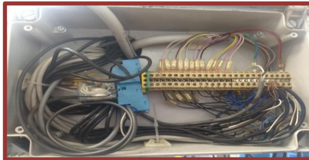
Imagen 1.52 Interior de un Gabinete, Cableado mal estructurado. (Fuente: IEA 2019)
