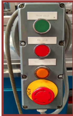
Imagen 1.92 Caja de Arranque y paro en óptimas condiciones. [Fuente: IEA 2019]
