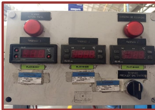
Imagen 1.70 Controladores de Temperatura deficientes. [Fuente: IEA 2019]
