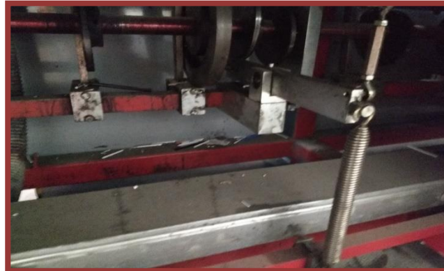
Imagen 1.67 Base de la maquina en mal estado. [Fuente: IEA 2019]
