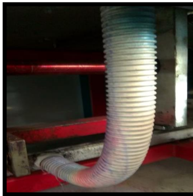
Imagen 1.96 Tubos de Liquid Tight en buen estado visual. [Fuente: IEA 2019]
