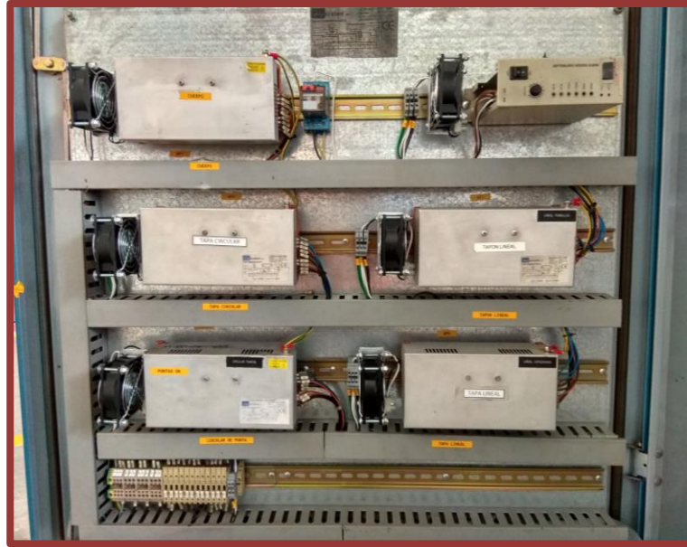
Imagen 1.90 Variadores de Frecuencia con Ventiladores. [Fuente: IEA 2019]
