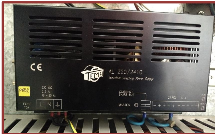
Imagen 1.57 Fuente de Alimentación, energizada al PLC. (Fuente: IEA 2019)
