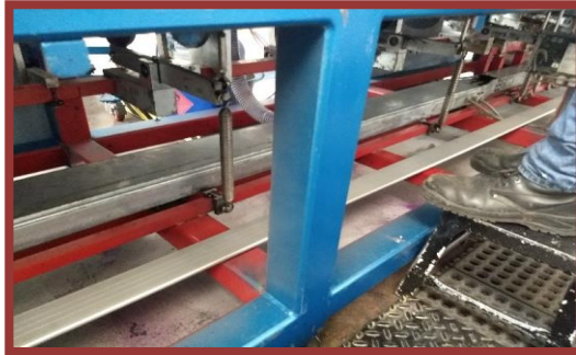
Imagen 1.95 Base de la maquina en buen estado. [Fuente: IEA 2019]
