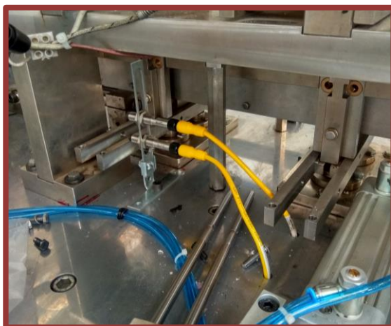
Imagen 1.97 Sensores Inductivos instalados para el control del pistón. [Fuente: IEA 2019]
