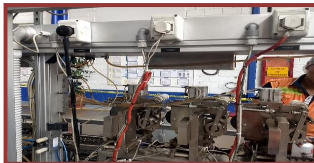
Imagen 1.66 Cable con mala estética y manchadas. [Fuente: IEA 2019]
