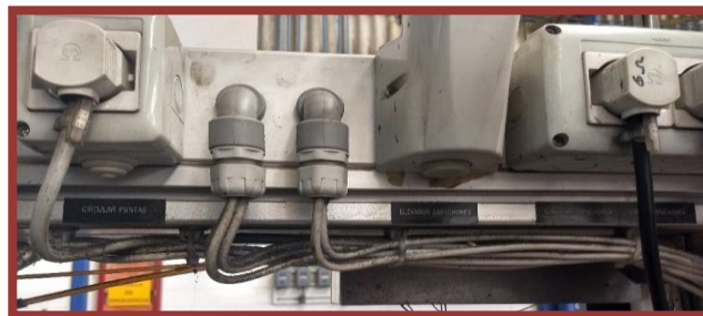
Imagen 1.65. Cables con mala estética. [Fuente: IEA 2019]
