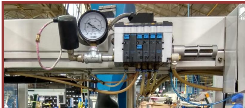
Imagen 1.93 Válvula, manguera y filtro en óptimas condiciones. [Fuente: IEA 2019]
