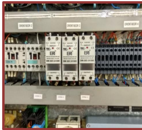
Imagen 1.99 Relevadores de Estado Sólido instalados. [Fuente: IEA 2019]
