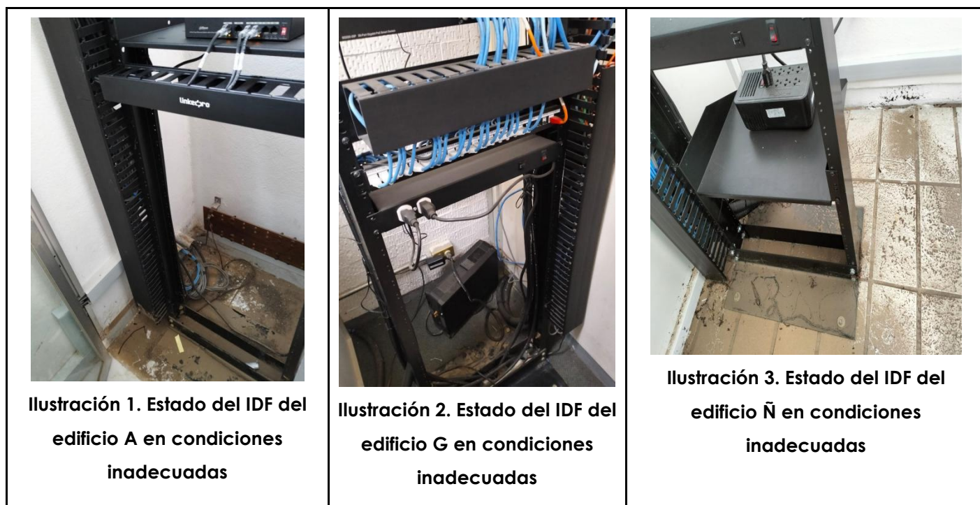
Figura 5.1 – Evidencia del estado físico deteriorado de los racks de comunicaciones.
