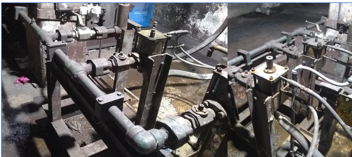
Ilustración 3.12: Tuberías de salida alternativa, fuente propia. [fotografía]
