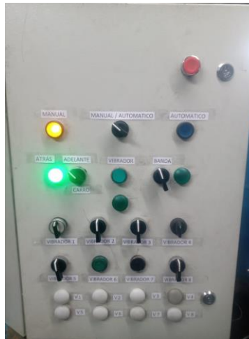
Figura 14.2.4. Pruebas de funcionamiento de tablero.
