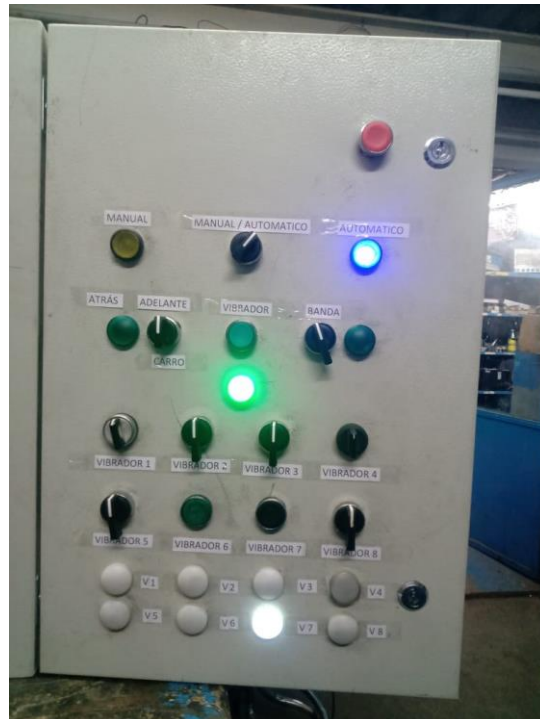
Figura 14.2.3. Pruebas de funcionamiento de tablero.
