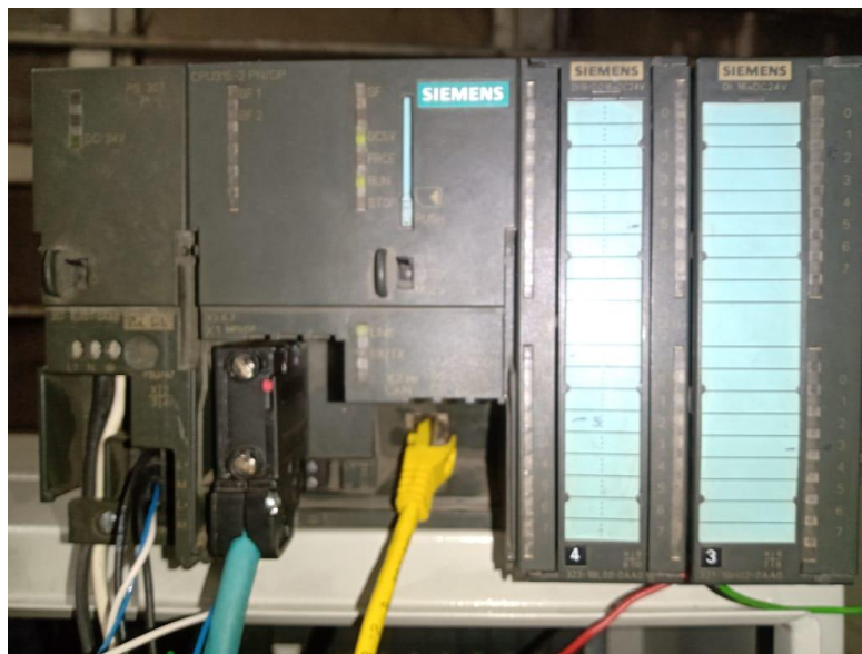
Figura 14.2.2. Utilización SIMATIC S7-300 CPU 315-2 PN/DP.
