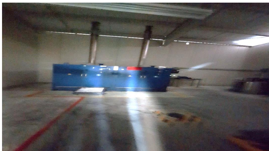
Imagen 14. Espacio de tanques y hornos (Parafina).
