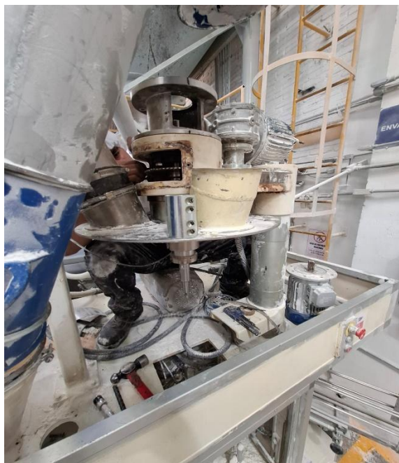
Ilustración 39: Mantenimiento al motor de tolva del barredor.
