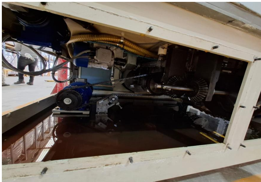
Ilustración 32: Falta de mantenimiento a la alimentación principal de la envasadora.
