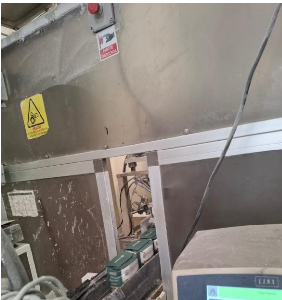
Ilustración 37: Mantenimiento al sensor de proximidad (se revisó la calibración).
