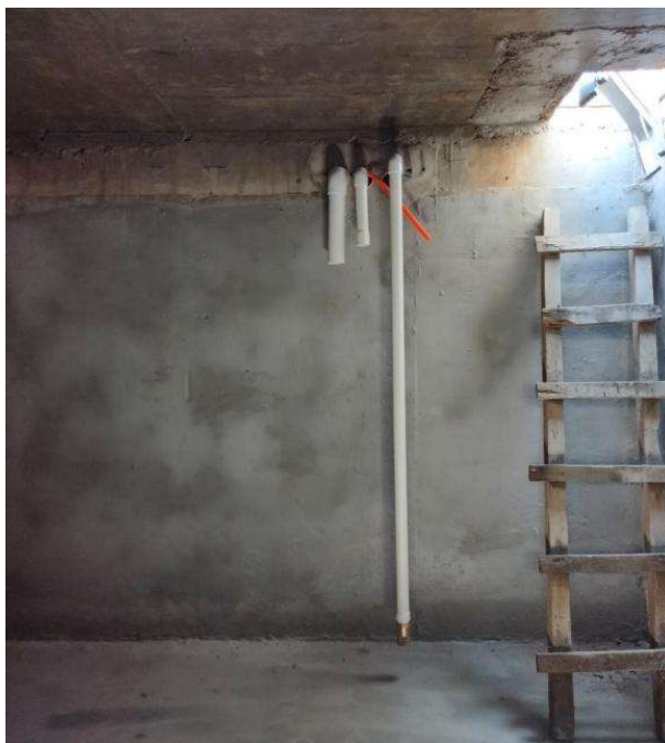
Figura 97. Entrada y succión de agua para cisterna
