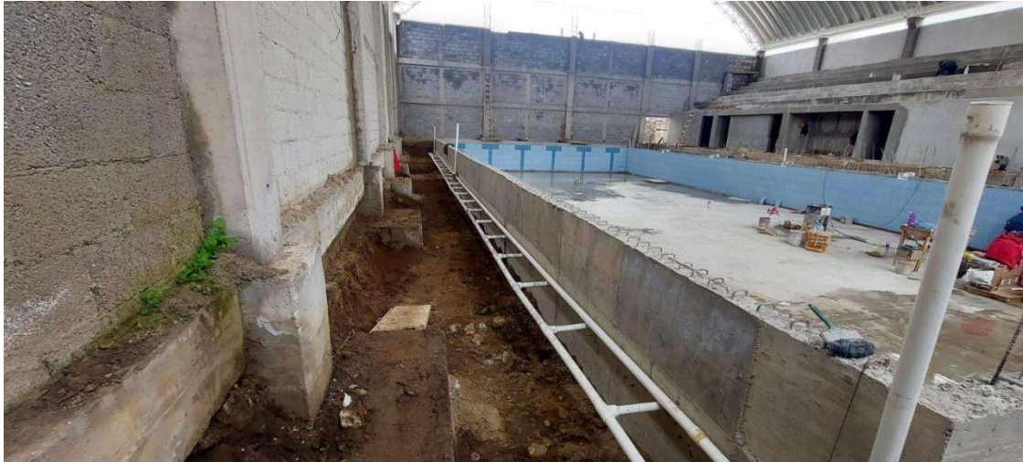
Figura 145. Conexión de tubería entre la alberca y equipos necesarios para su funcionamiento
