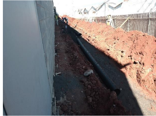
Ilustración 103 Insta. Pluvial. Fuente propia
