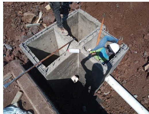
Ilustración 101 Trampa de grasas. Fuente propia
