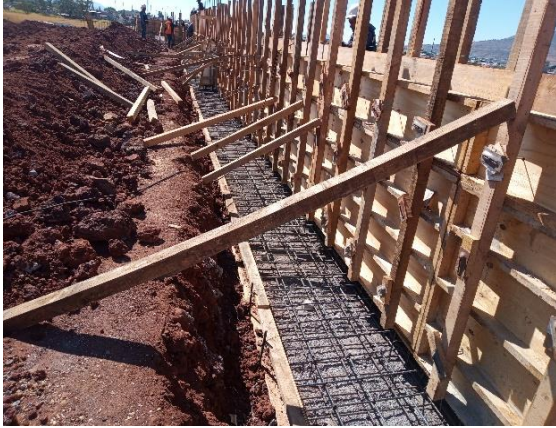
Ilustración 22 Cimbra de cimentación. Fuente propia
