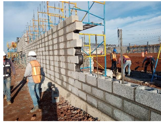
Ilustración 47 Sonoflex en muro. Fuente propia
