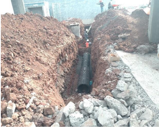
Ilustración 118 Insta. Pluvial. Fuente propia
