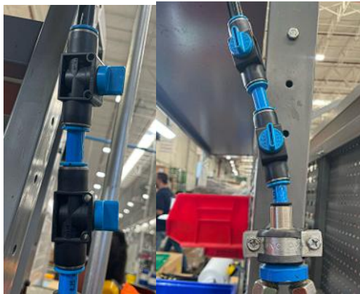
Ilustración 27 Válvulas de paso.
