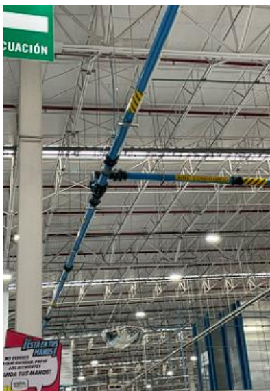
Ilustración 25 Toma de aire comprimido principal.
