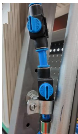
C) Válvulas de paso
