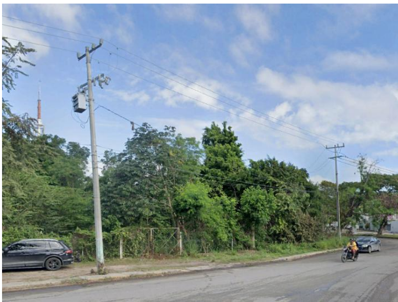
Figura 29 Postes de energía eléctrica.
