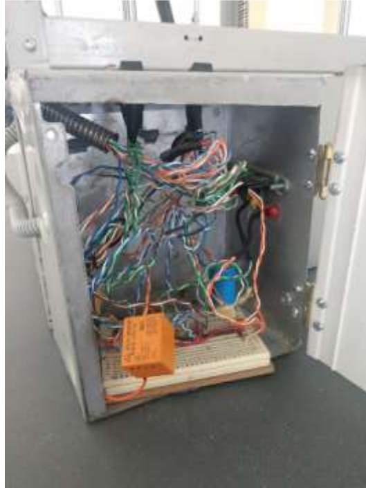
Figura 71. Interior de gabinete de distribución eléctrica.
