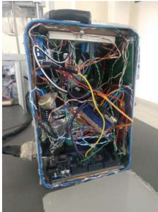
Figura 73. Interior de gabinete de panel de control.
