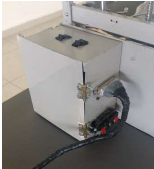
Figura 66. Caja de poder (gabinete de distribución eléctrica).
