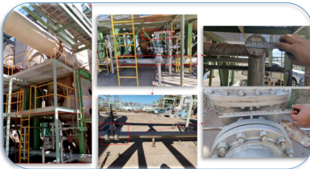
Figura 3.2. Punto de extracción del recurso geotérmico en el separador de humedad de CPI-U5. Fuente: Francisco-Hernández (2025).
