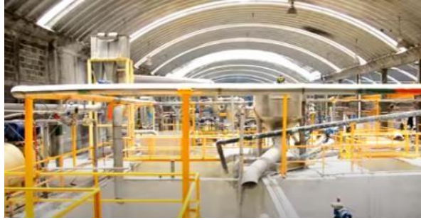
IMAGEN 1.4 PLANTA DE TRATAMIENTO DE AGUAS. FUENTE: CONVERTIDOR DE PAPEL SA DE CV.
