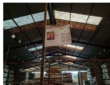
Ilustración 57 Tarimas en mal estado.
