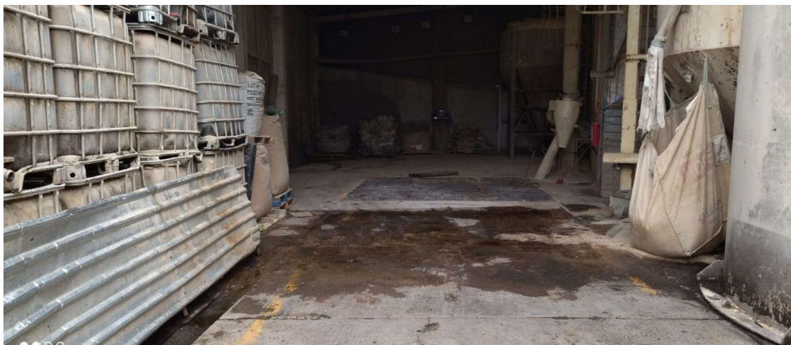
Ilustración 43 Zona de descargas
