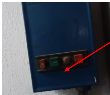
Ilustración 14 Módulo de control que energiza la máquina de tensión
