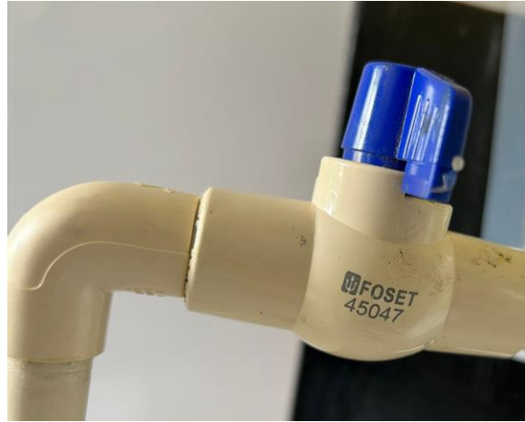
FIGURA 25. CONEXION DE CODO (AUDITORIA PROPIA).
