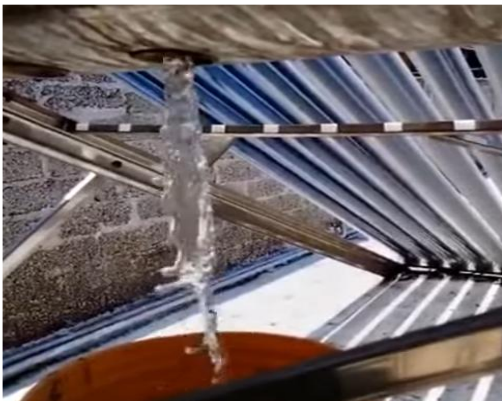
Figura 15. Drenado parcial de termotanque
