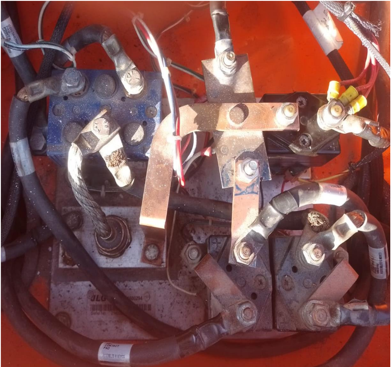
figura 1.1.7 banco de contactores
