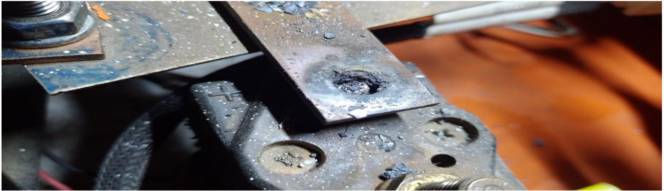
figura 1.2.8 contactor con daño en un borne de contacto por sobrecarga
