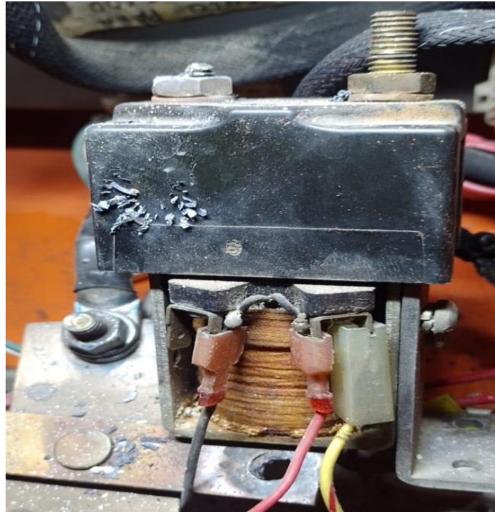
figura 1.1.6 contactor primario, trabaja con 48vcc
