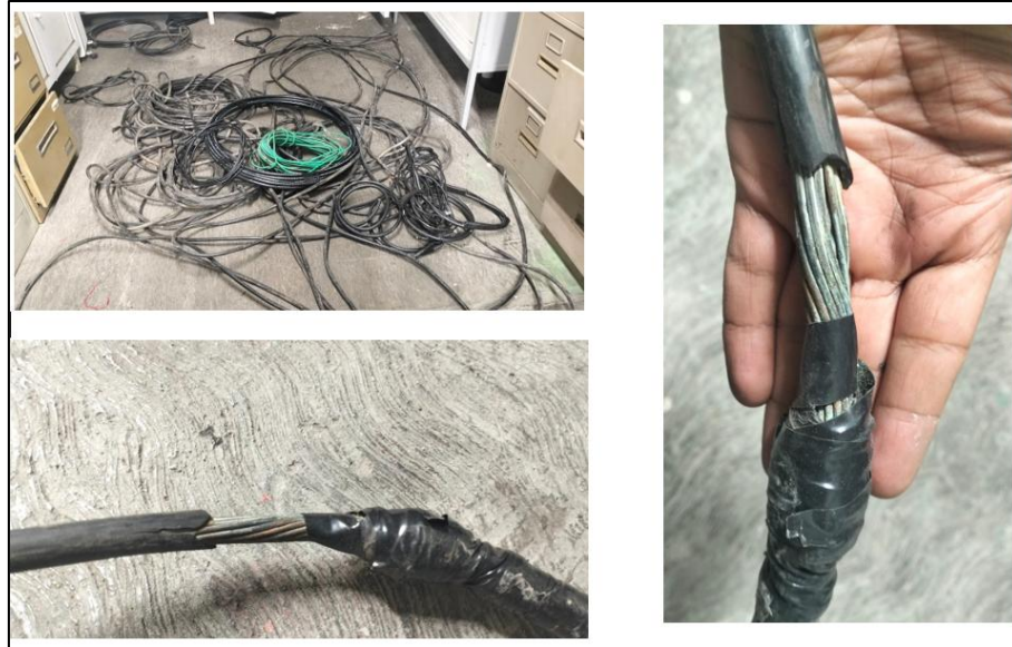
Figura 22 Estado del conductor eléctrico
