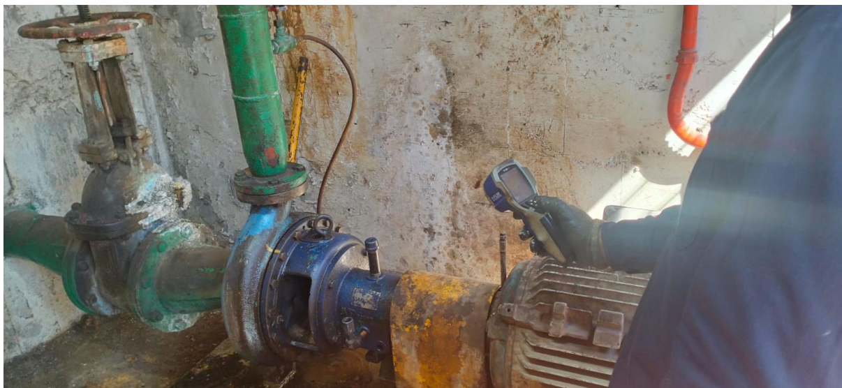
Figura 16. Medición de termografía motor-bomba de cisterna #1
