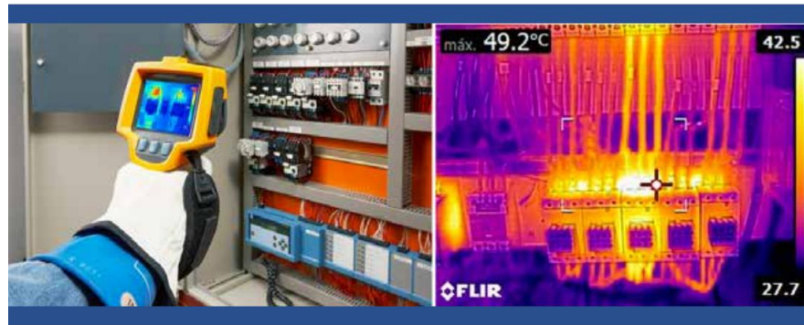
Figura 8 Imagen termográfica, (crédito: airproject.cl/termografia )
