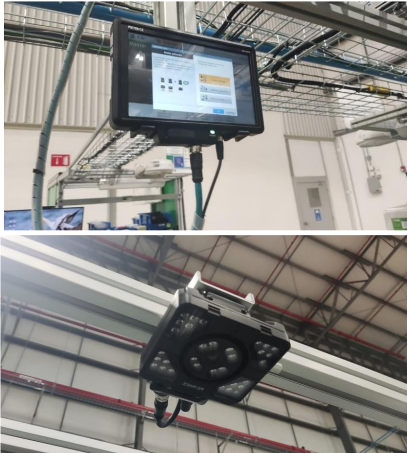
Imagen 34. Instalación del sistema de visión en una de las líneas. El sistema incluye una pantalla de visualización que permite programar la cámara.
