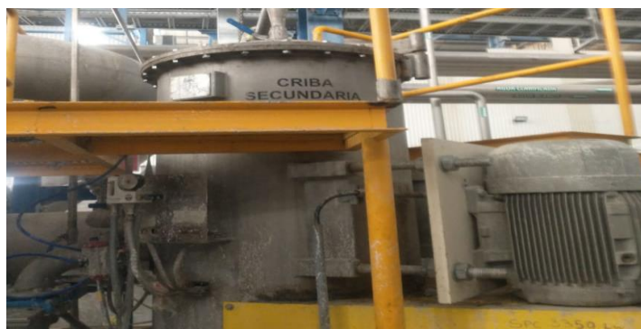
Figura 32 Depurador vertical para el Cribado secundario Nota. Fotografía tomada por el autor durante el periodo de Residencia Profesional, febrero de 2025.
