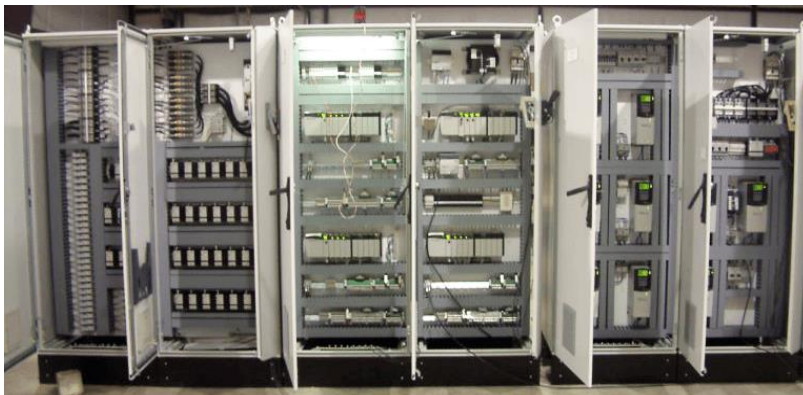
Figura 9 Componentes de un Tablero de Control
