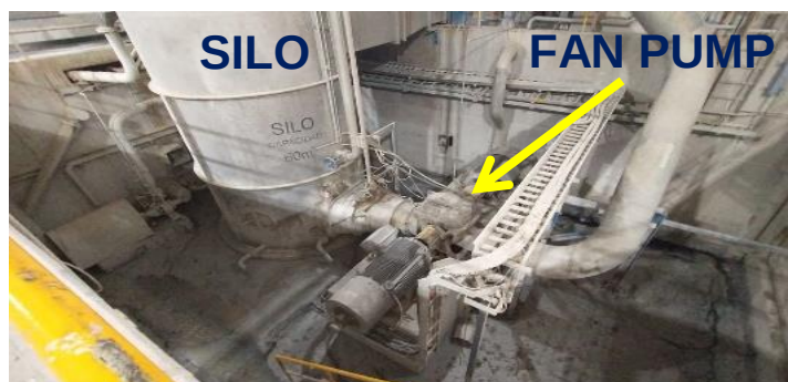
Figura 29 Silo de 60,000L. conectado a Bomba Fan Pump
