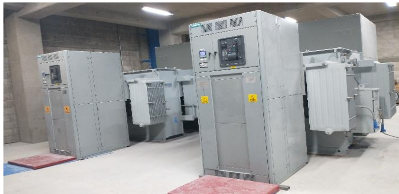
Figura 7 Subestación 6 de CONVERTIDOR DE PAPEL S.A. DE C.V. Nota. Fotografía tomada por el autor durante el periodo de Residencia Profesional, febrero de 2025.
