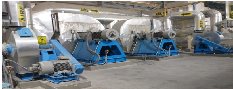
Figura 46 Bombas de succión de aire para transportarlo a los Quemadores Nota. Fotografía tomada por el autor durante el periodo de Residencia Profesional, febrero de 2025.
