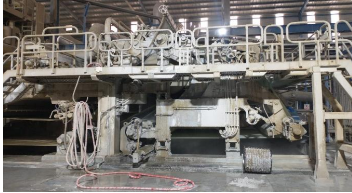
Figura 36 Parte lateral de la caja de entrada, rodillo formador y rodillos guía Nota. Fotografía tomada por el autor durante el periodo de Residencia Profesional, febrero de 2025.
