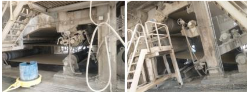
Figura 39 Depósito de drenado de agua debajo del Filtro Nota. Fotografía tomada por el autor durante el periodo de Residencia Profesional, febrero de 2025.
