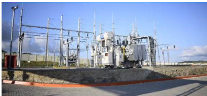
Figura 6 Subestación para controlar, distribuir y suministrar energía a una industria
