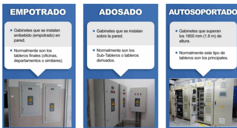
Figura 11 Tipos de Instalación en Tableros eléctricos
