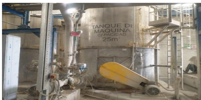
Figura 28 Tanque de Maquina 25,000L
