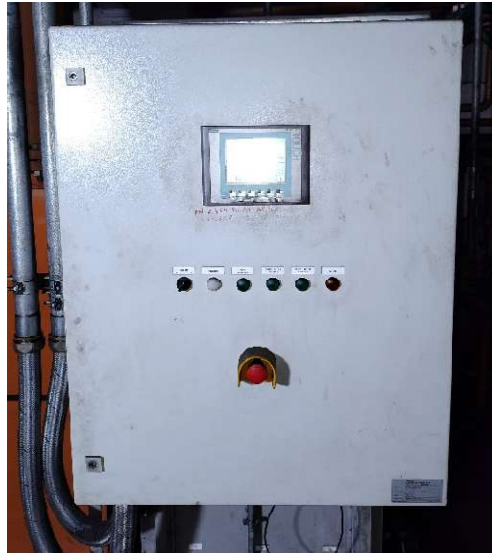
Imagen 11. Tablero de central AO
