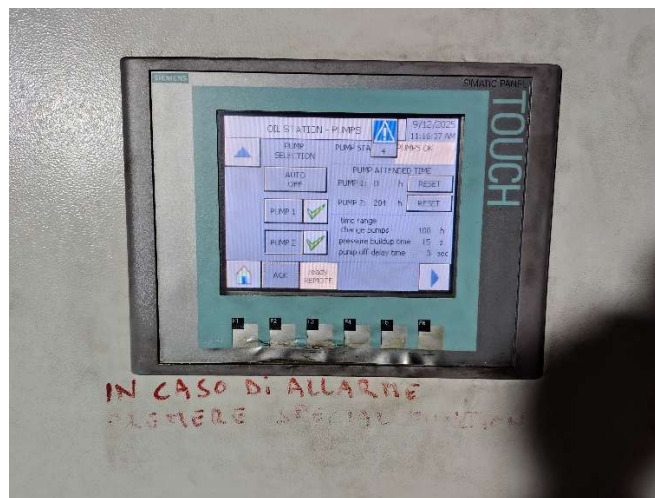
Imagen 12. HMI local de central AO
