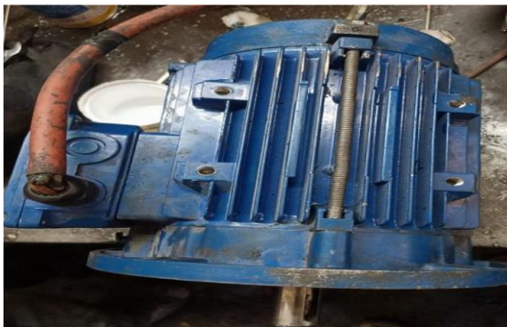
ILUSTRACIÓN 29 MOTOR QUEBRADO DE LA CARCASA
