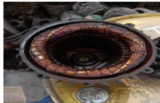
ILUSTRACIÓN 32 MOTOR CON RECUBRIMIENTO EN EMBOBINADO.
