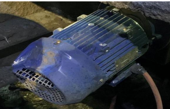
ILUSTRACIÓN 27 ABOLLADURA DE TAPA MOTOR
