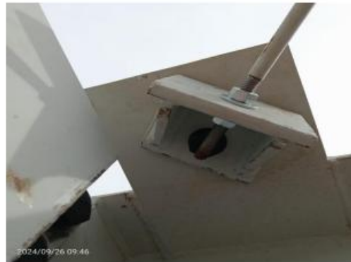
CORRECTA INSTALACION DE CAJAS DE CONTRAVIENTO X8"-Y3
