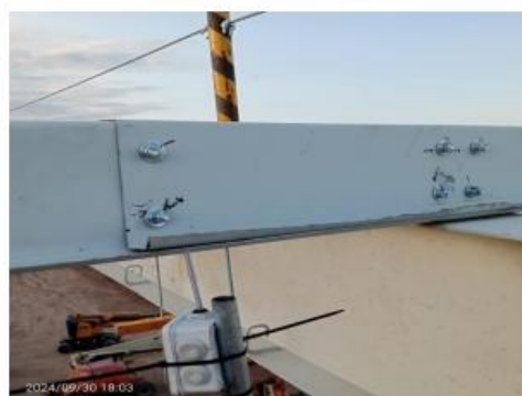
TORNILERIA DE CUBIERTA FLOJA ENTRE EJES X6" Y 1 - Y2
