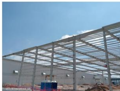
OMISION DE STRUT DE CABEZERA DE FACHADA
