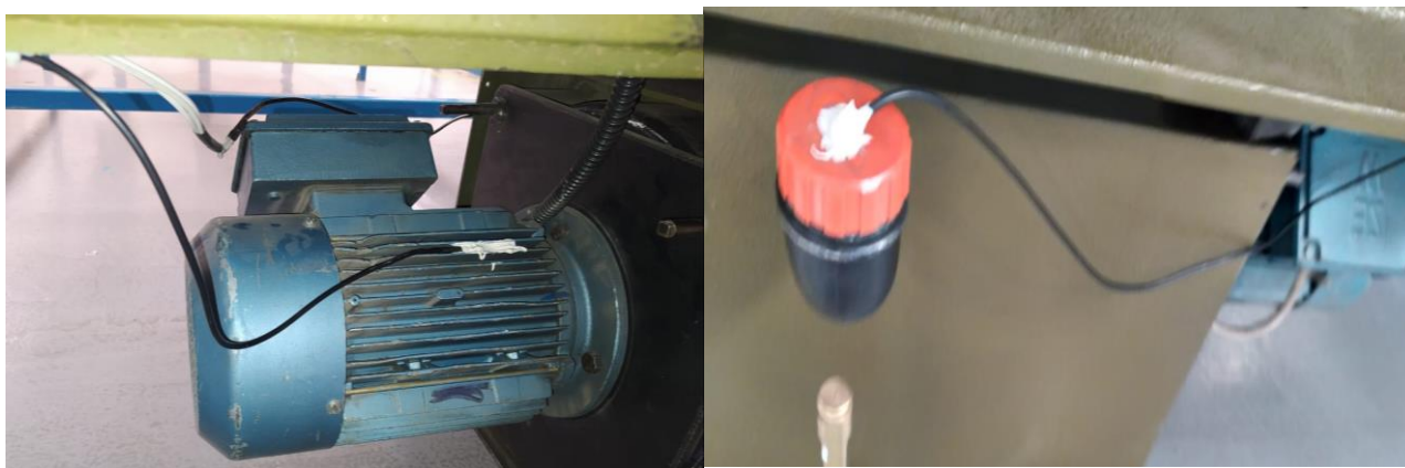
Figura 28.- Sensores de temperatura instalado en el motor(izquierda) y sensor de temperatura en tanque de aceite hidráulico (derecha) [Fuente: Propia, 2021]
