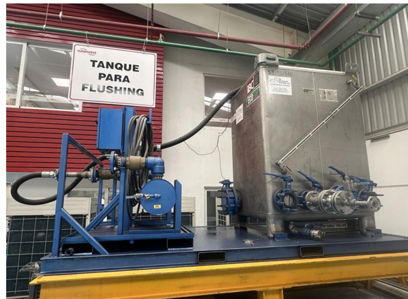
Figura 14 Tanque de flushing en Nave B SA.
