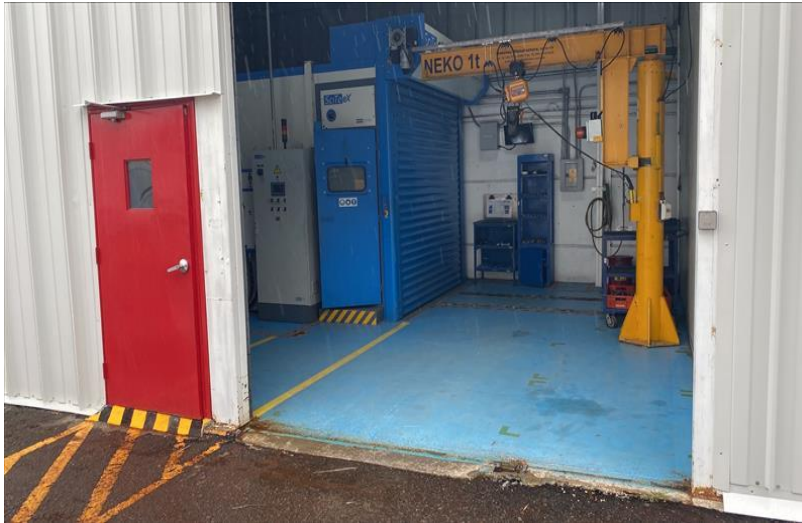
Figura 16 Cabina de Shotblast (Anexo Nave B).
