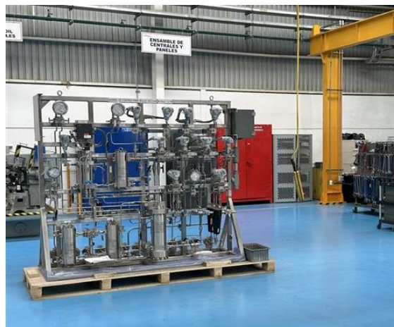
Figura 11 Área de Ensamble de centrales y paneles Nave B SA.
