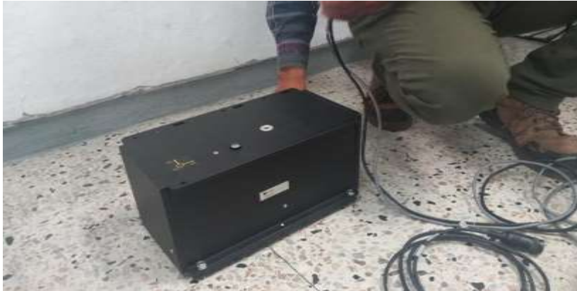
Imagen 44. Conexión de Cables
