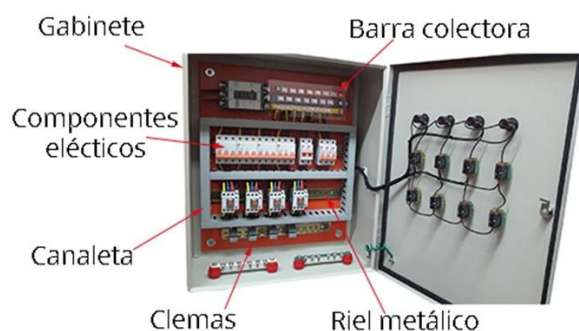
Figura 10 Tablero de control eléctrico y su distribución general.
