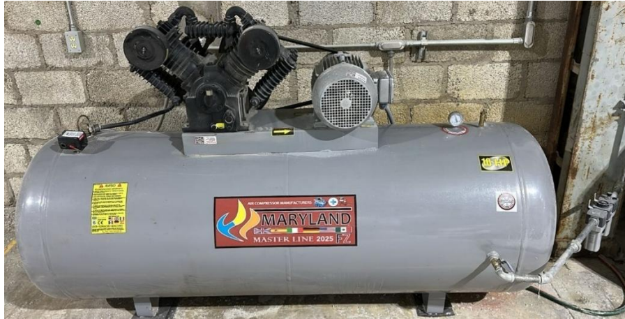
Figura 5 Compresor de Doble Pistón de la empresa ECOCHEM.
