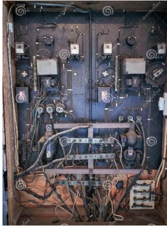
Figura 11 Tablero de control eléctrico del siglo XIX.
