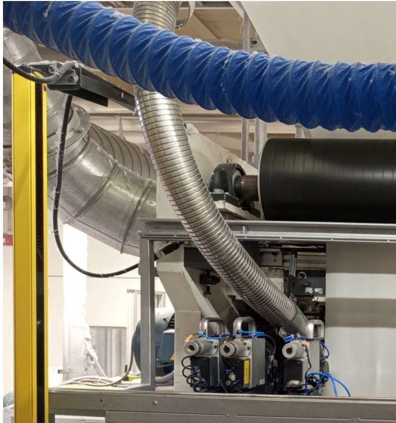
Ilustración 16 sistema de recolección en funcionamiento
