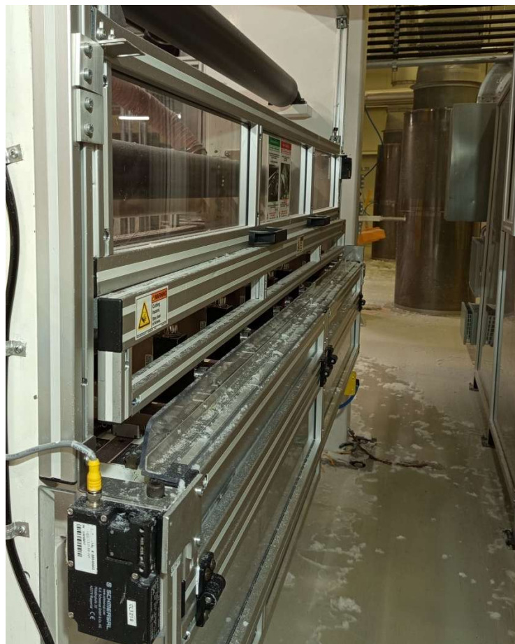
Ilustración 27 en la imagen se observan las guardas que impiden el acceso a los slitters, de maquina 2
