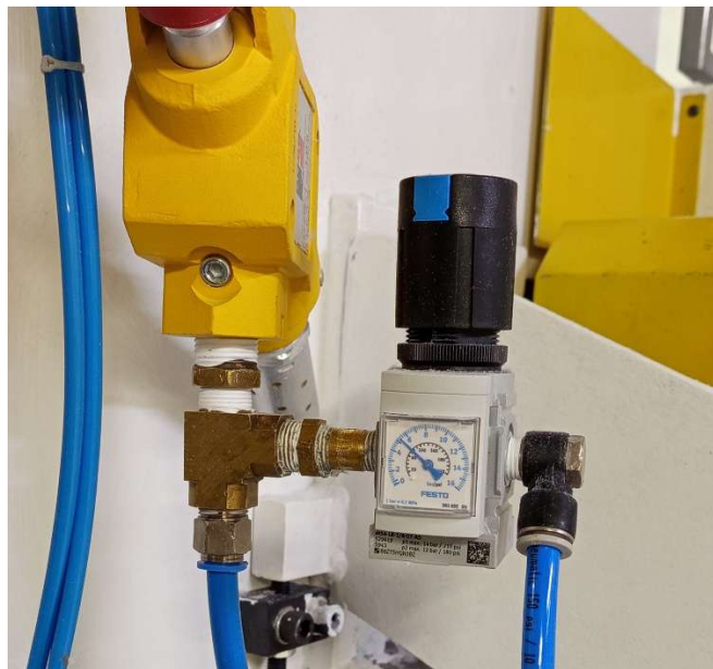
Ilustración 61 filtro regulador, y dispositivo de bloqueo neumático que suministran aire al sistema
