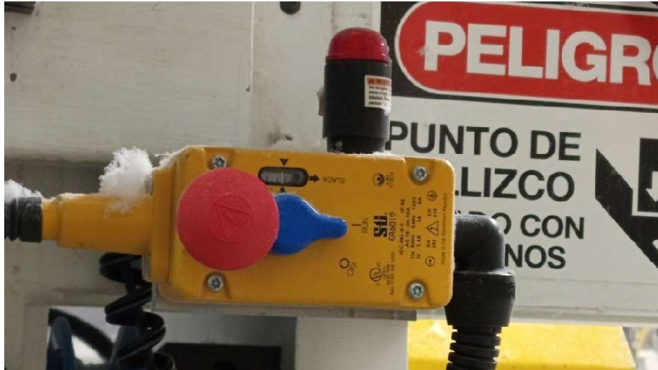
Ilustración 14 sistema de paro de emergencia por tracción del sistema de slitters
