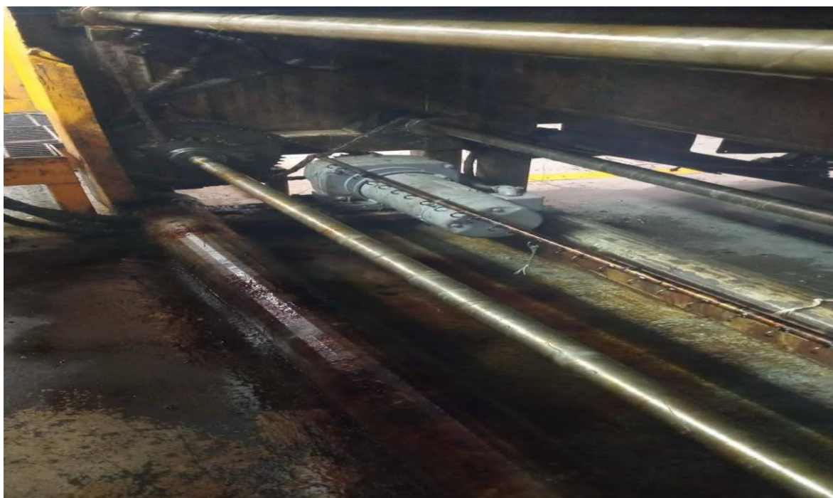
Figura. 3.2.6.2 Falla cadena fuera de catarina y desajuste. [Fuente: Elaboración propia, 2022.].
