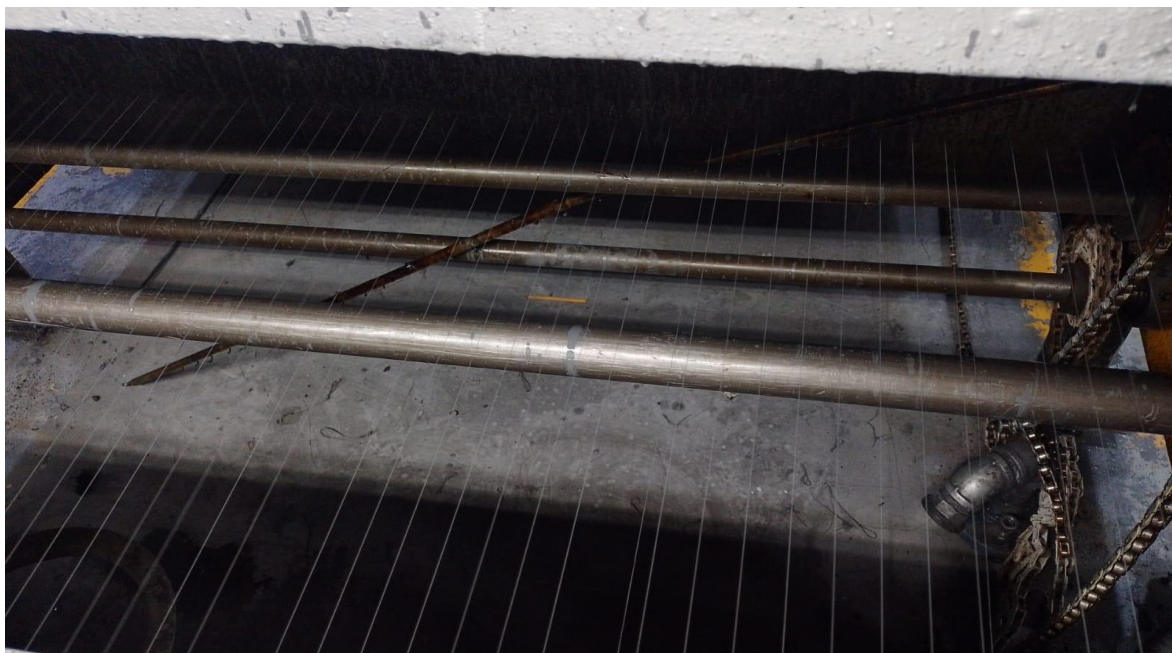
Figura. 3.2.6.1 Falla de barra transportadora ocasionando ruptura de cadena. [Fuente: Elaboración propia, 2022.].
