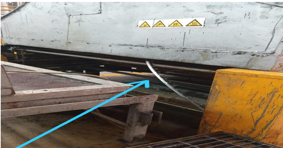
Figura. 3.2.6.4 Falla de barra transportadora doblada y entre los ejes. [Fuente: Operario de recubrimiento, 2022].
