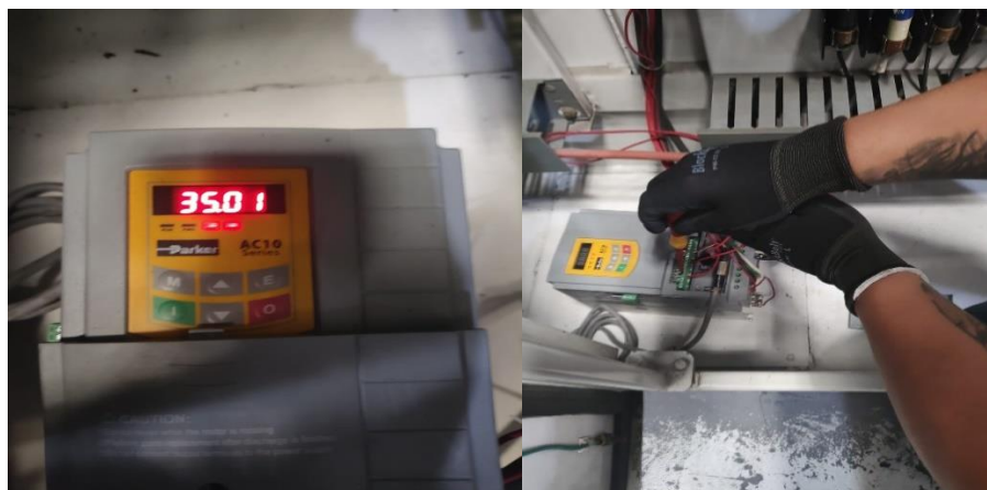
Figura. 4.1.2. Colocación y programación de variador. [Fuente Alfonso Alvarado, 2022.].
