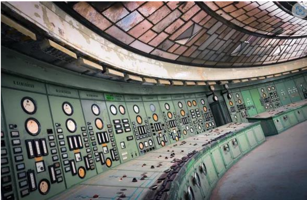
Figura 1.1.1. Antiguos Tableros de PLC
