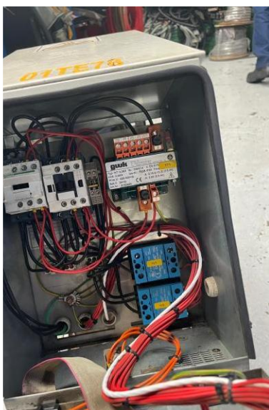
Imagen 30. Cableado y control interno de termorregulador GWK, Eugen Wexler, 2025
