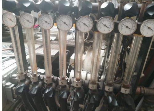
Imagen 28. Flujómetros limpios y funcionando maquina 41, Eugen Wexler, 2025
