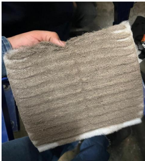
Imagen 19. Filtro sucio de tablero de control maquina 45, Eugen Wexler, 2025.
