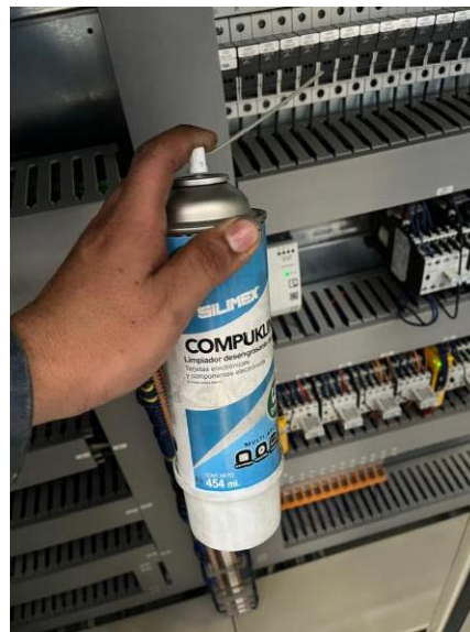
Imagen 16. Limpieza a tableros de control 45, Eugen Wexler, 2025
