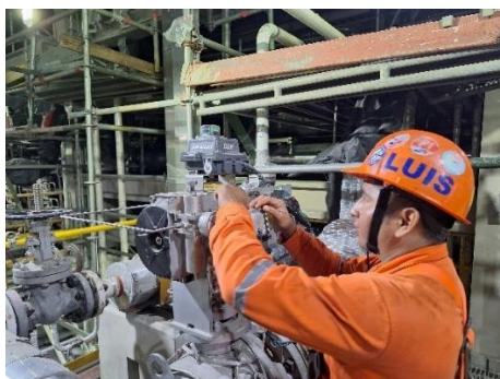
Figura 23. Válvulas ON-OFF accionada manualmente y por solenoide
