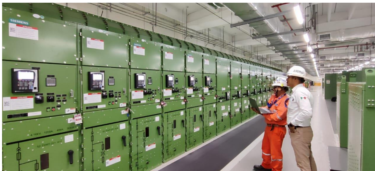
Figura 63. Pruebas de energización de equipos junto a PEMEX
