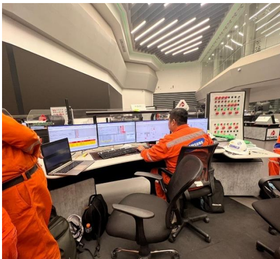
Figura 81. Cuarto de control donde están los controladores (DCS) y de ahí mandan los comandos y reciben señales. llamado cuarto control central (CCC)
