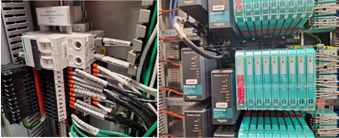
Figura 57. Tableros de Control
