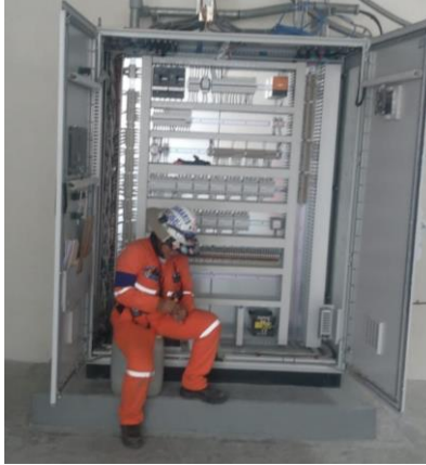
Figura 65. Tablero de Protección contra altos voltajes
