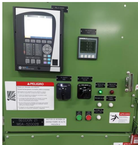
Figura 64. Interruptores de tablero eléctrico
