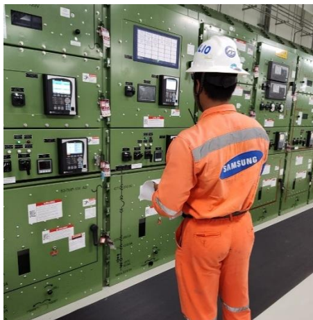
Figura 58. Permisivos para el arranque de bombas de carga desde tablero eléctrico en subestación
