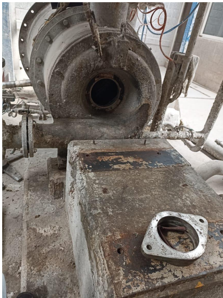
Ilustración 3-11 Rotor y flecha desmontada del Multinet Fuente: Elaboración propia
