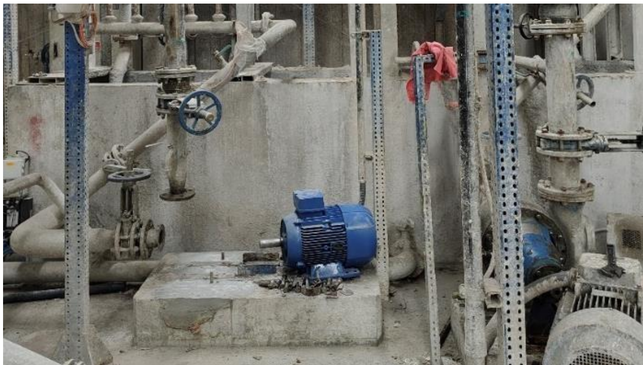
Ilustración 3-37 Desmontaje de bomba de cleaners Fuente: Elaboración propia
