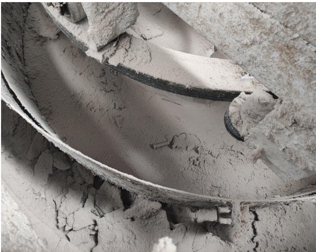
Ilustración 4-1 Daf con neoprenos llenos de polvo y agrietados Fuente: Elaboración propia
