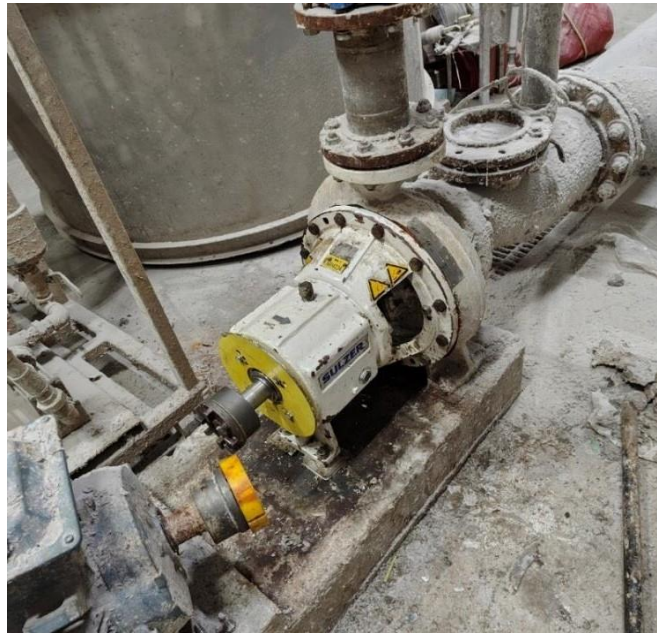
Ilustración 3-45 Montaje de bombas Fuente: Elaboración propia
