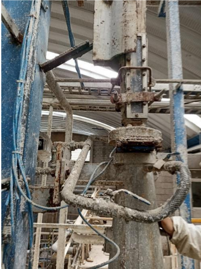
Ilustración 4-10 Equipo HDC en mal estado Fuente: Elaboración propia
