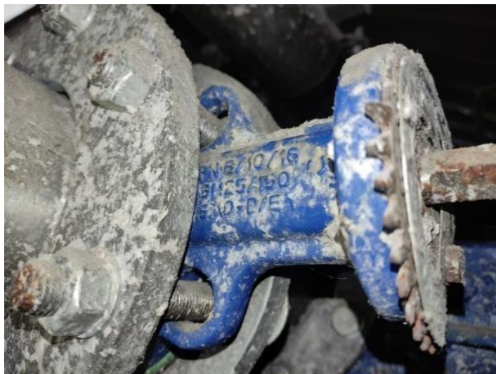
Ilustración 3-16 Válvula de descarga en mal estado Fuente: Elaboración propia
