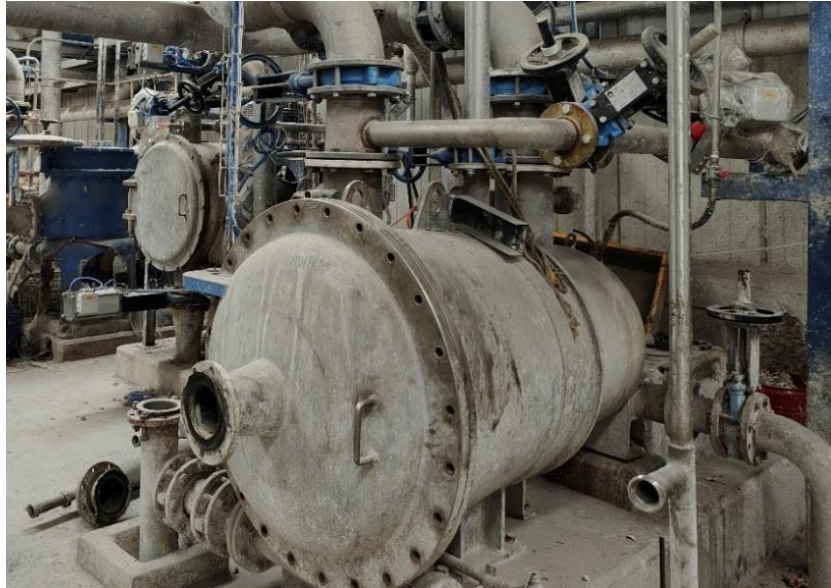
Ilustración 4-5 Multinet desmontado sin limpieza Fuente: Elaboración propia
