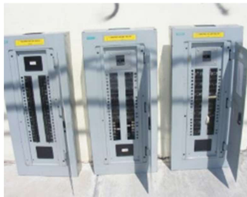
Ilustración 6.3.4 Tablero de distribución y centro de carga
