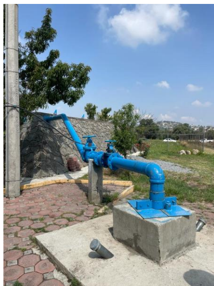
Imagen 7 Tren de descarga de agua potable
