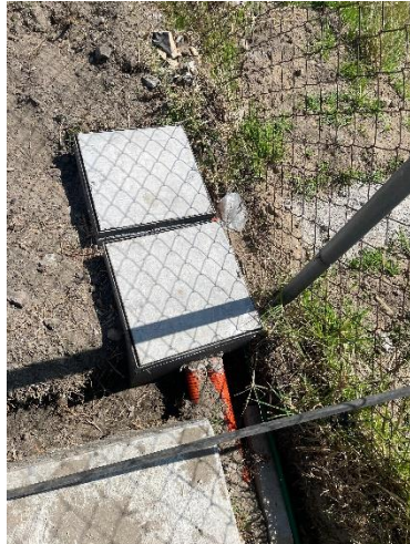
Imagen 59 Conexiones de inyectores
