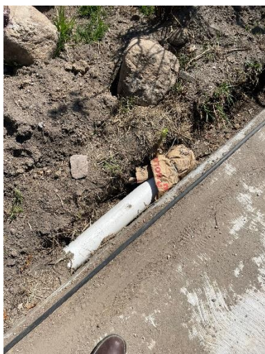
Imagen 57 Tubería de PVC
