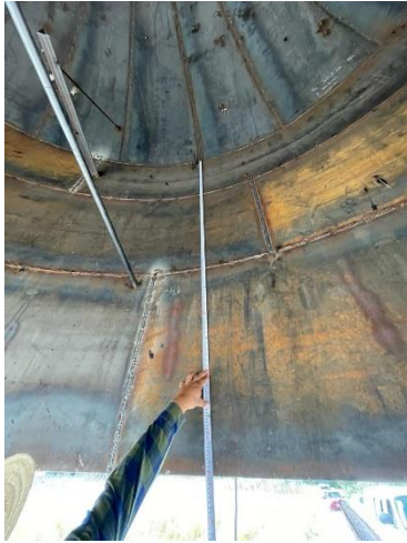
Imagen 76 Medición de tanque
