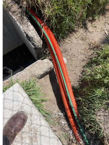
Imagen 60 Tubería de conexión
