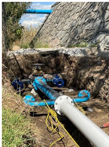
Imagen 61 Tubería de bombas
