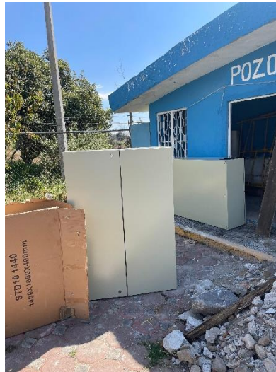
Imagen 67 Gabinete de control de internet
