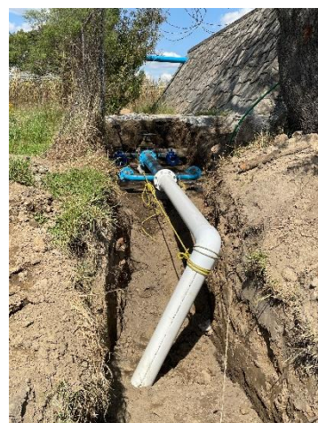
Imagen 62 Tubería de bombas
