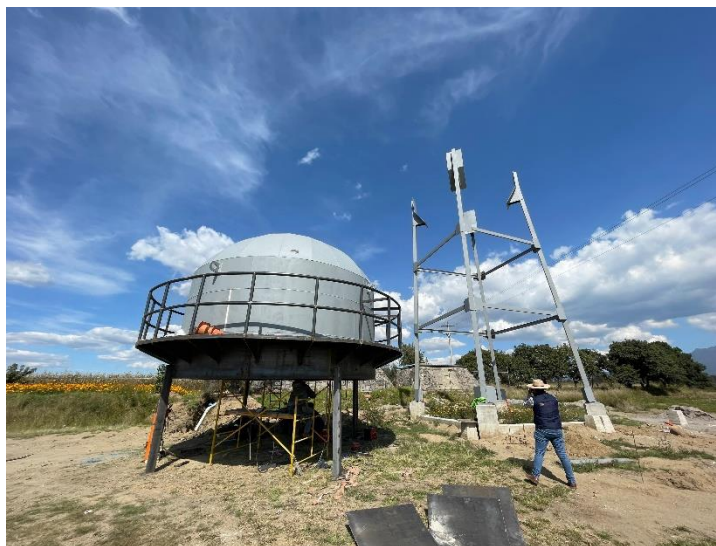
Imagen 75 Tanque elevado y su respectiva torre
