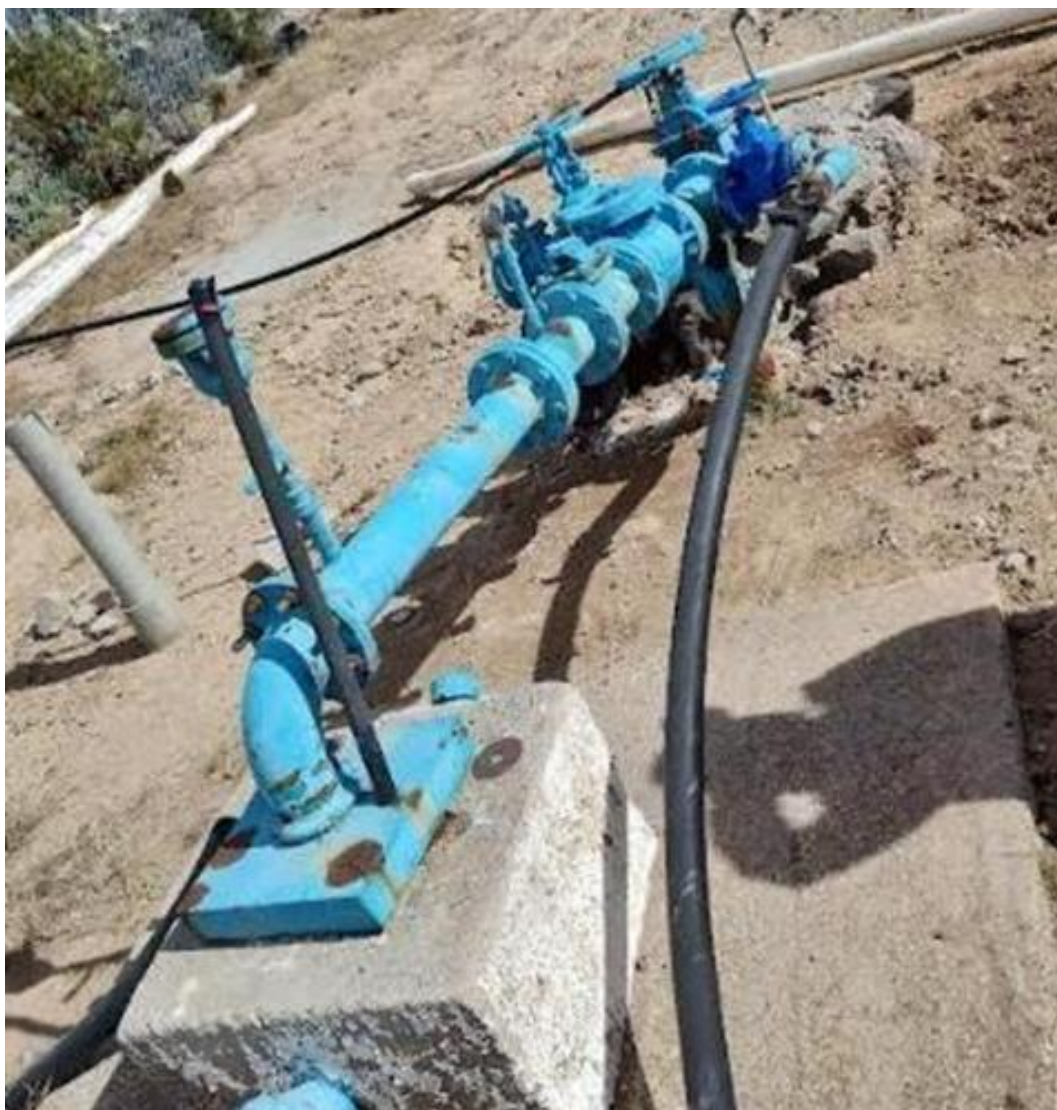
Imagen 18. Tren de descarga de Pozo No. 1
